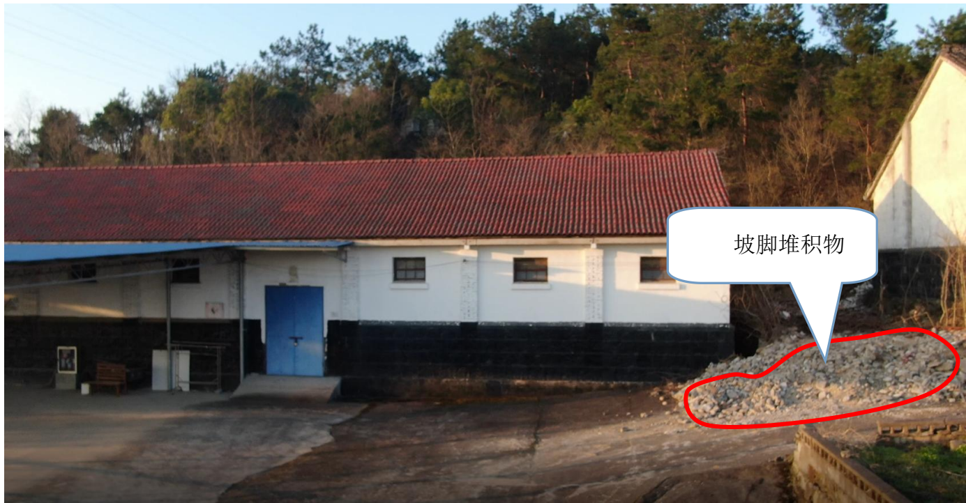
照片 7 坡脚堆积物照片 1（镜向北）
